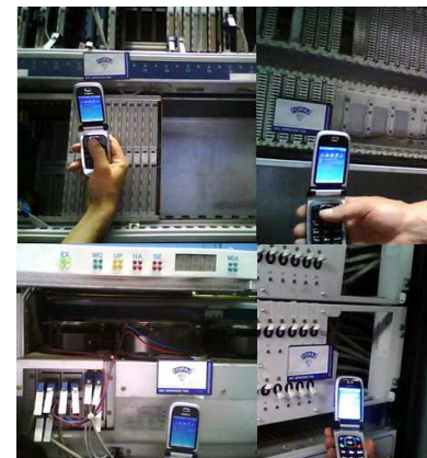
Figura 10. Partes de la central de entrenamiento etiquetadas
